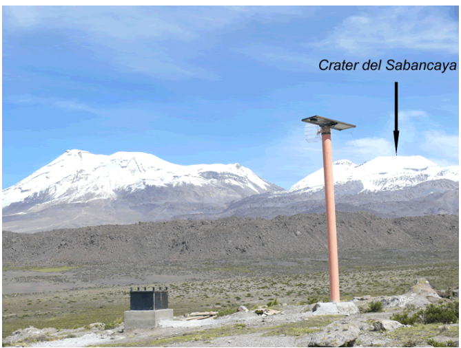
Foto Nº 1 Estación sísmica Telemétrica de Cajamarca CAJ (Foto V. Montesinos)
